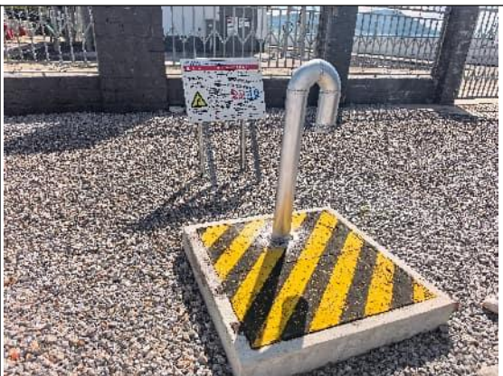
升压站主变事故油池 35m 3
