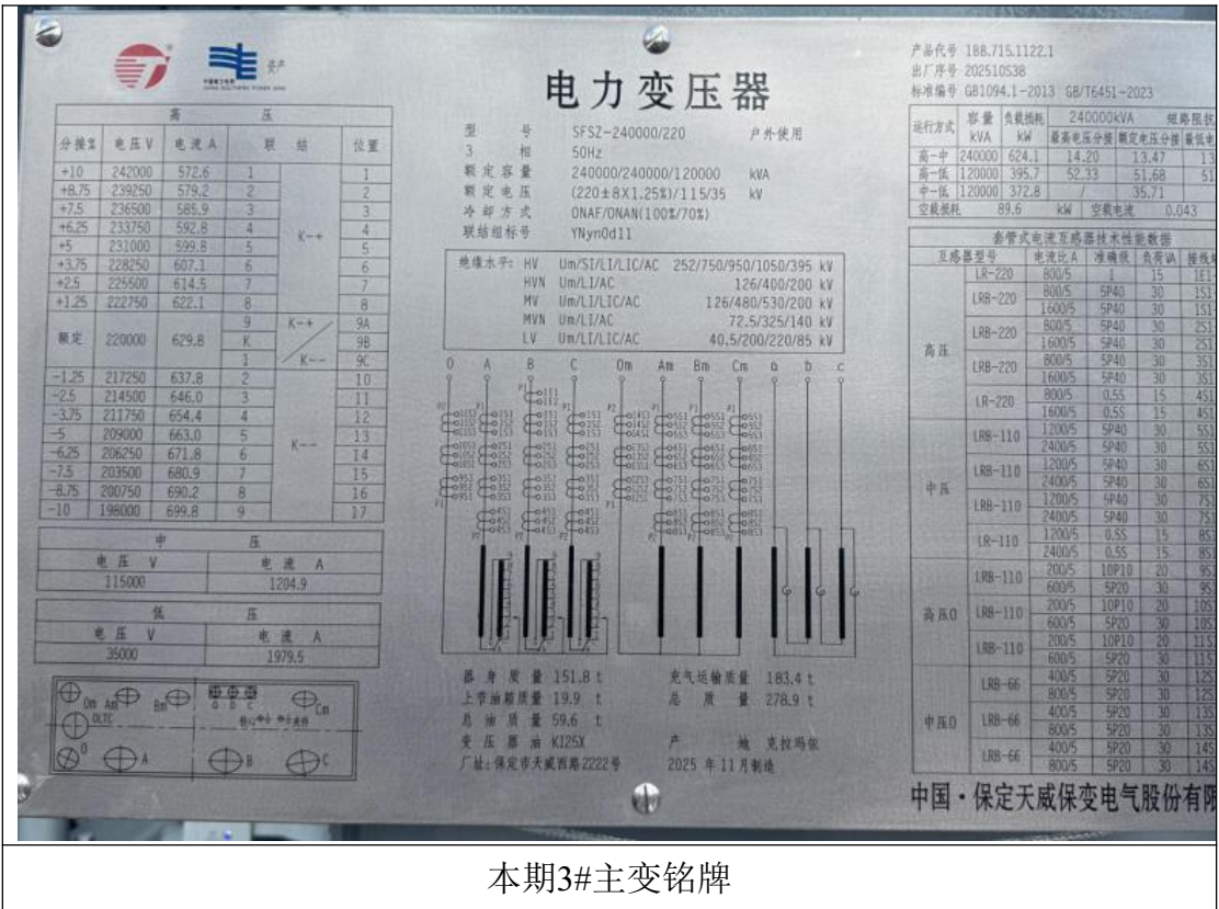
图 8-2 本期扩建 3#主变压器铭牌
