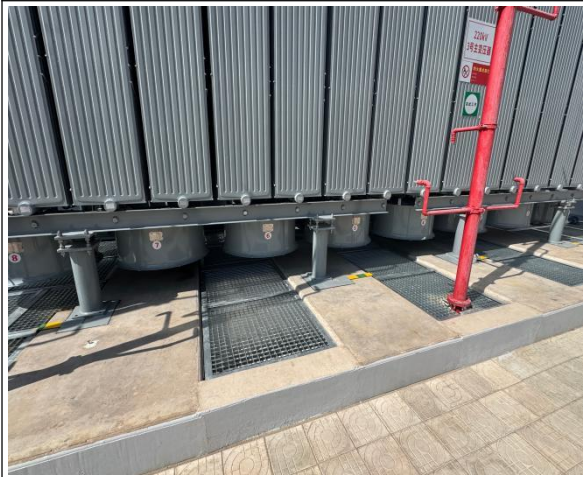
新建3#主变下方集油坑
