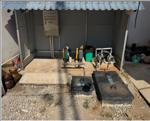
地埋式污水处理装置
