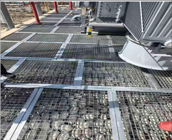
已建1#、2#主变下方集油坑
