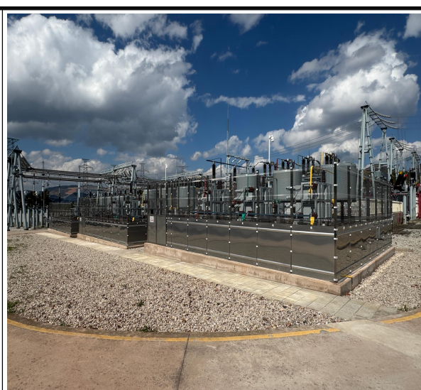
新建 35kV 电容器组
