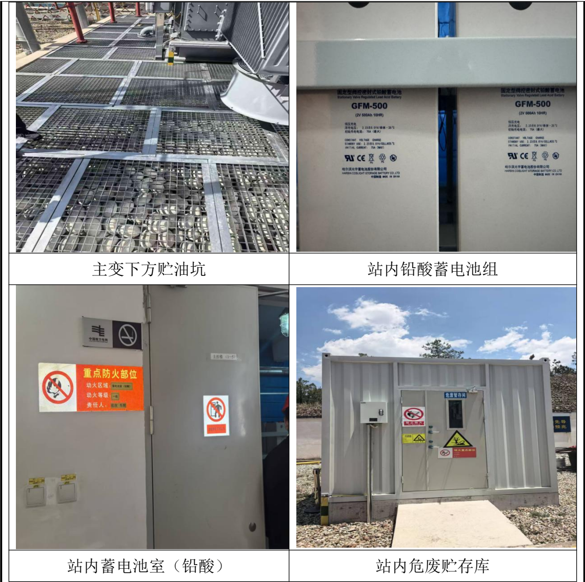
图 8-1 站内事故油排蓄系统、铅酸蓄电池组及危废贮存库
