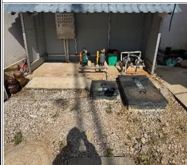
一体化污水处理设施
