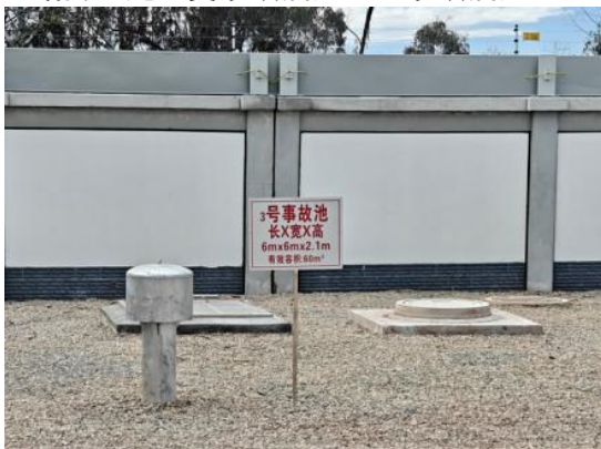
本期新建主变事故油池（3#事故油池）
