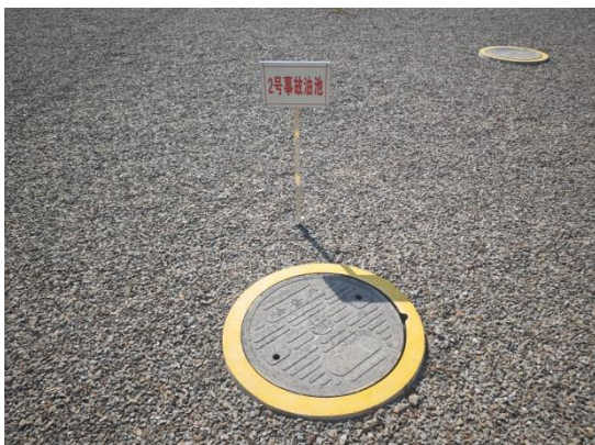
站内已建主变事故油池（2#事故油池）
