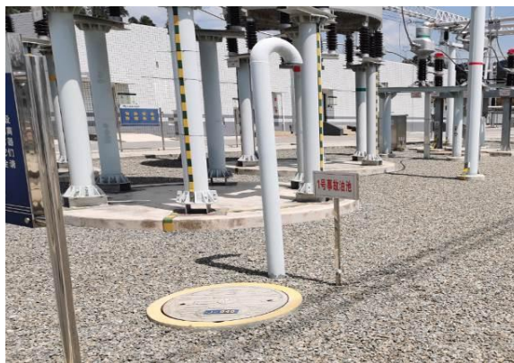
站内已建高抗事故油池（1#事故油池）
