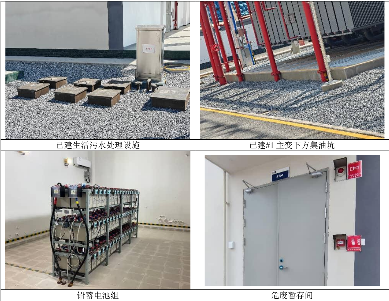
图8-2 站内污染防治设施照片
